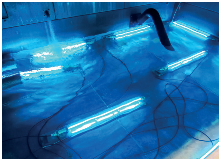
Clean Aero est une solution hybride développée par MPC pour le traitement des eaux industrielles des tours aéroréfrigérantes (TAR). Ici, une application sur une TAR d'un Data Center situé dans la région lyonnaise, installée en 2018.
